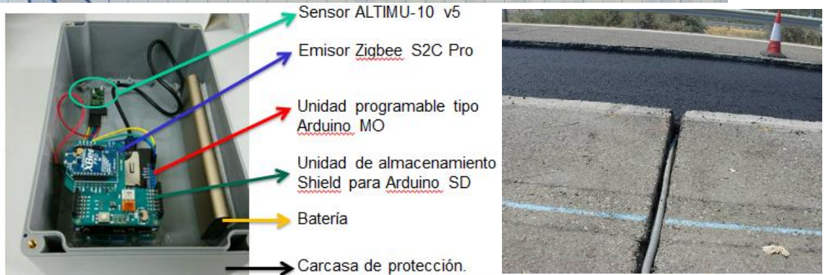
Figura 3 Subsistema de comunicación de corta distancia mediante cableado (izquierda), Ejemplo de nodo sensor que integra tanto el subsistema hardware como el de comunicación (derecha).
